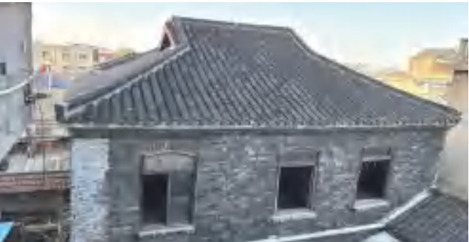
图5 原青砖墙体酥碱发白照片
