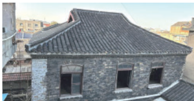
图5 原青砖墙体酥碱发白照片
